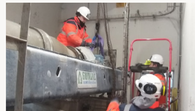
Maintenance centrifugeuse - Station d'épuration de Haybes-Fumay
